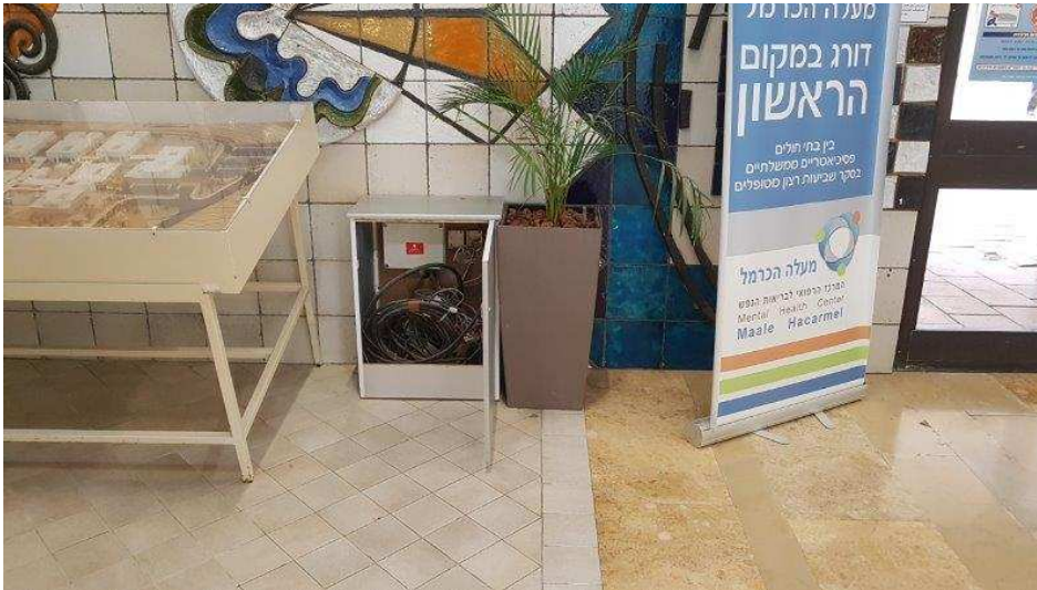
איור מס' 8 – דוגמא, ארון ריכוז תקשורת מקומי הממוקם בלובי הכניסה ומחובר לפיר התקשורת המרכזי
