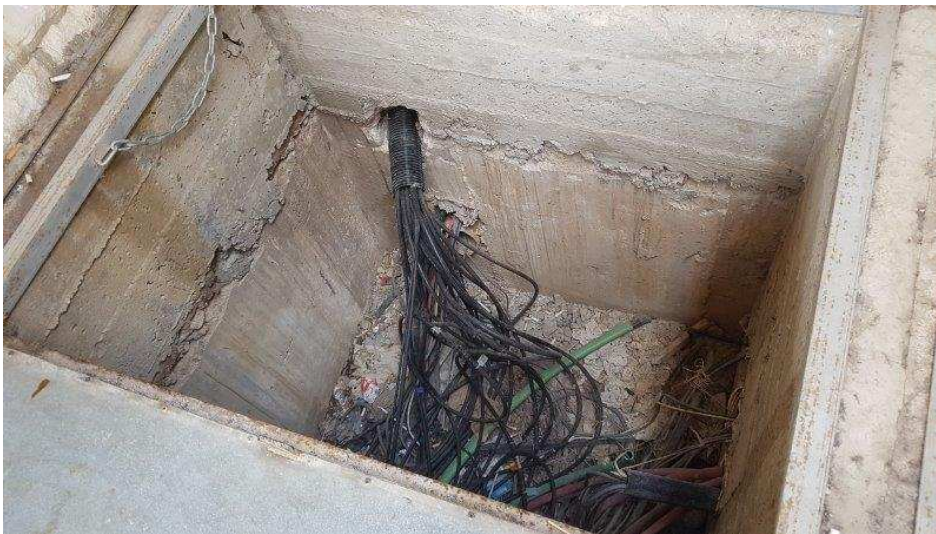
איור מס' 7 – פיר תקשורת מרכזי סמוך למבנה המנהלה מקושר למנהרות למבנה הנהלת המרכז
